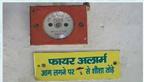
Emergency Fire Alarm Point എമർജൻസി ഫയർ അലാറം പോയിൻ്റ്
